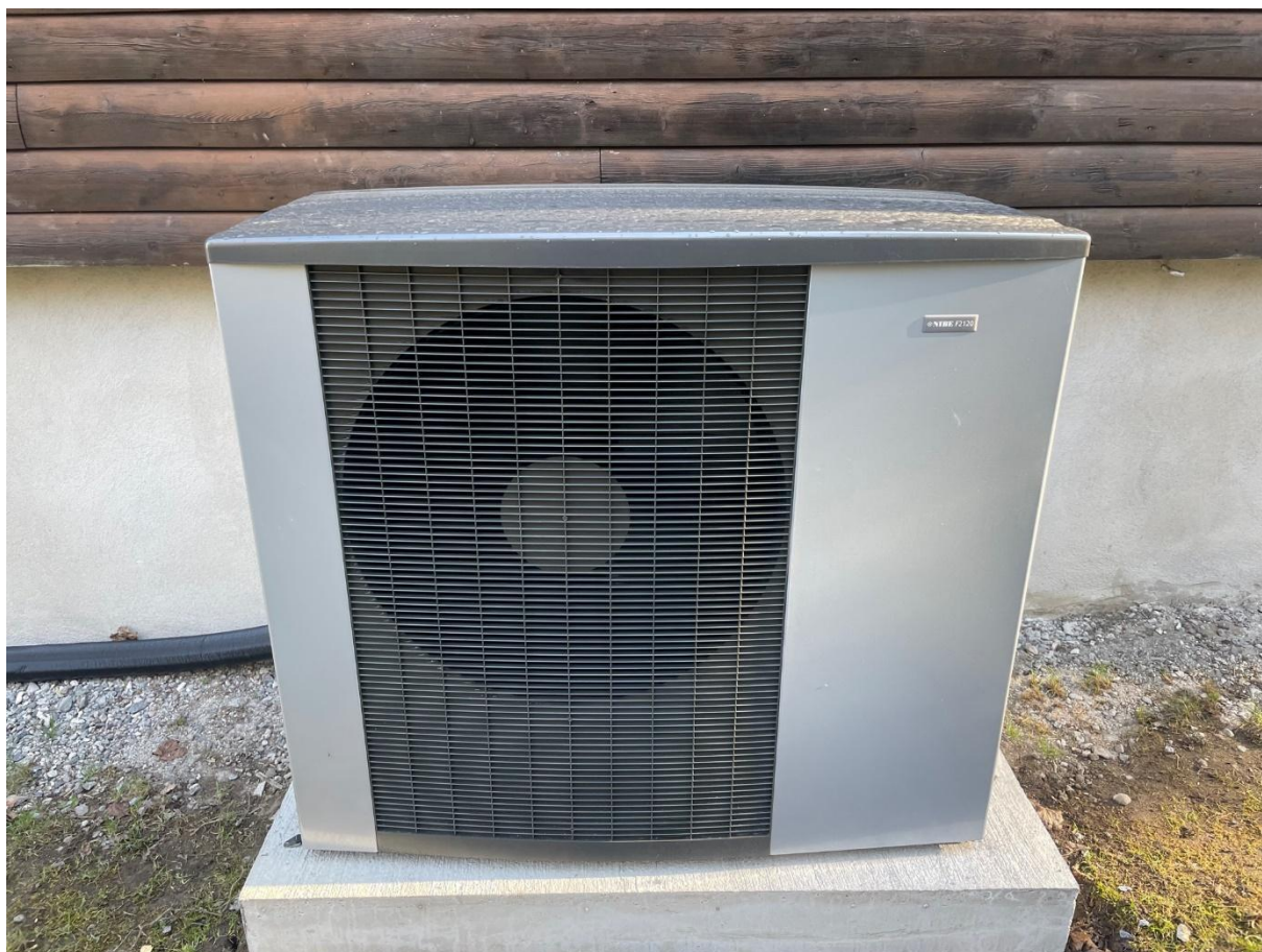
Den nya luft-vattenvärmepumpen bakom Järlagården.
